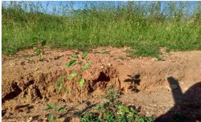
Figura 12 – Processo erosivo em área margeante ao Riacho Cajazeiras
