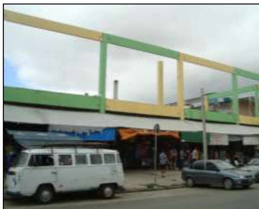
Figura 03 - Prédio com estrutura de concreto inacabada que abrigou parte dos permissionários do Beco da Poeira. (Fonte: GONÇALVES, 2013).
