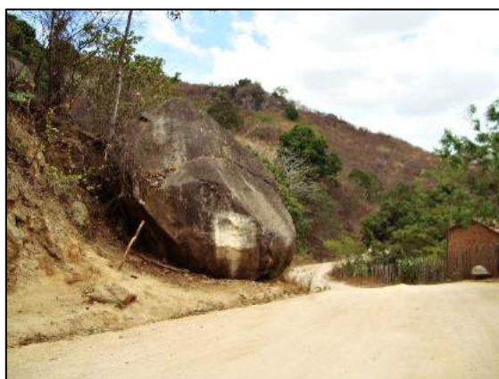
Figura 3 – Queda de bloco de volume da ordem de \text{m}^3 , a montante da barragem do Rio Mundaú, em estrada não pavimentada de acesso ao município de Uruburetama, Ceará. Fonte: Autores (2014).
