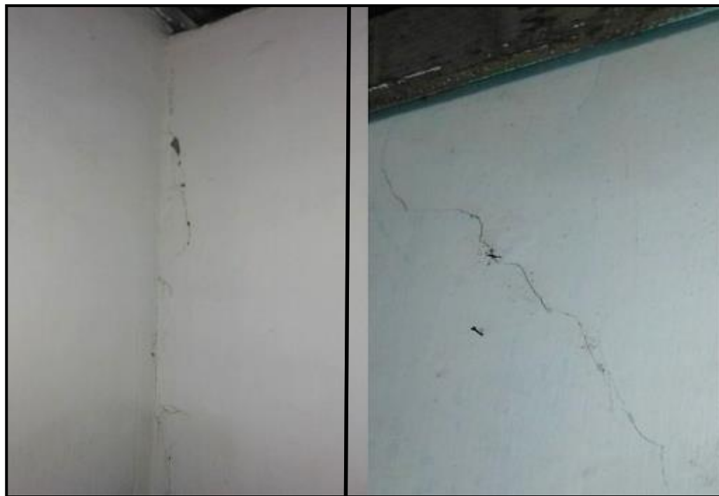
Figura 03. Rachaduras nas casas de moradores cerca de um quilometro de uma das áreas de lavra.
