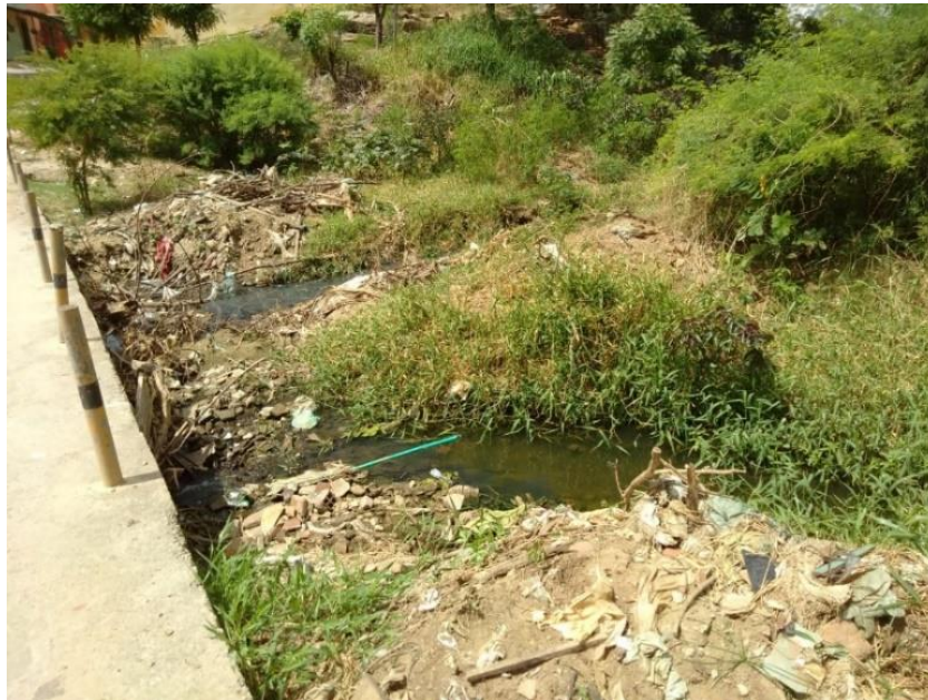
Figura 04. Ponte inacabada da Rua Antônio Tomé, com entulhos no Rio Canindé. Fonte: Viana, 2019
